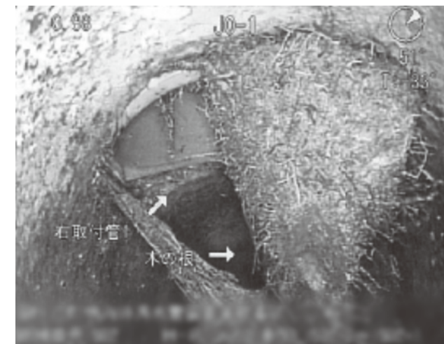
【写真-1】木根の侵入状況その1
