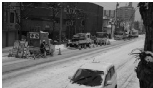
■写真-1 寒冷地でのアルファライナー H工法の施工状況
