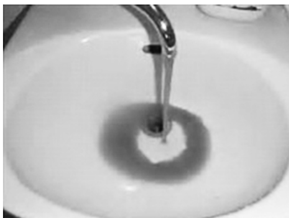
写真-1 水道の赤水
