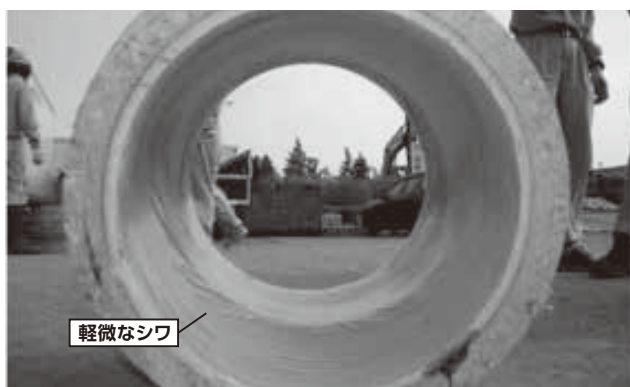
写真1 模擬管による試験施工(隙間100mm、段差50mm、上) 更生後の断面確認(φ400mm、下)
