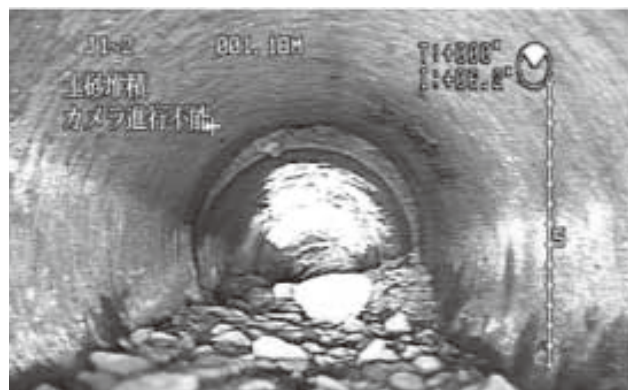
写真2 地震による既設管の損傷例
