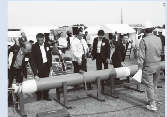
●東北地域支部 10月4日、管路協主催の「管更正技術施工展東北」(宮城県総合運動公園)に出展しました。塩化ビニル管の管更正をデモ施工でご覧いただきました。
