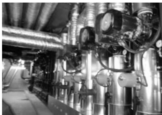
■写真3 IKEA店舗地下の熱交換施設
