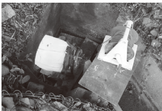
■写真5 UVライト点灯状況(上流側)
